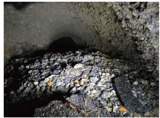
確認された路面直下の空洞
