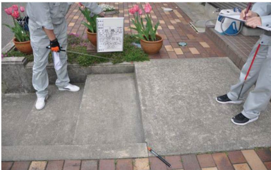
工事損害調査
